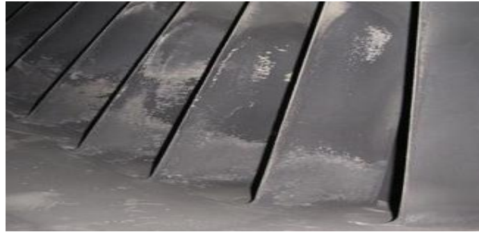
Figure 3-3 Fouling of compressor blades (Kurz 2007)
